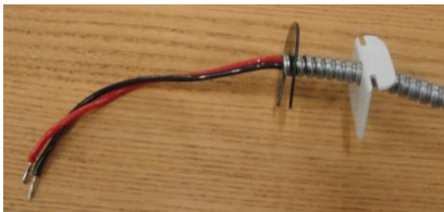
Fig. 9. Power Cable Thru Conduit
